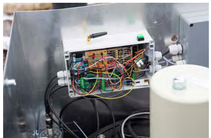
waterretentiekragen en slim actief watermanagementsysteem © DakAkker Rotterdam
